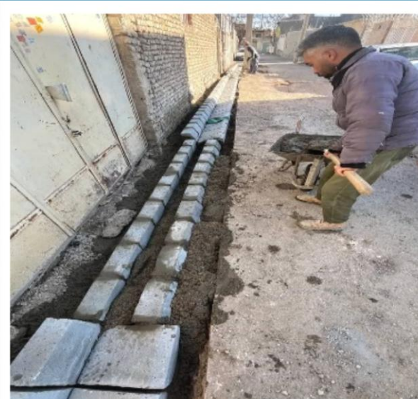
هدایت آبهای سطحی نیروگاه
